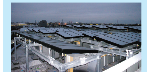
屋上に設置されたソーラーパネル
